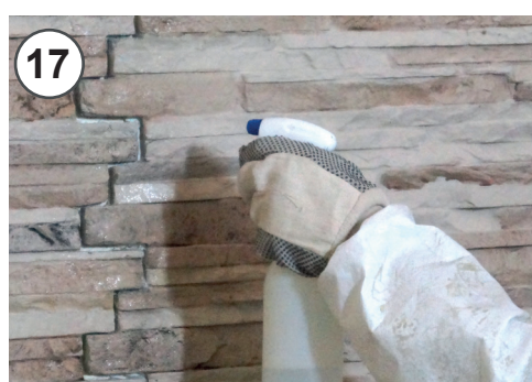
17 - Inumidire il giunto con acqua nebulizzata prima dell'applicazione dello stucco 17 - Humidification of joint by water spray before grouting
