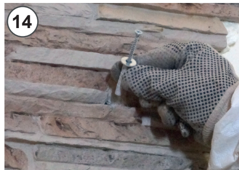
14 - Fissare provvisoriamente il pannello con tassello viti e rondelle sino a presa della schiuma 14 - Temporary fastening of the panel by fisher, screws and washers until the foam grip
