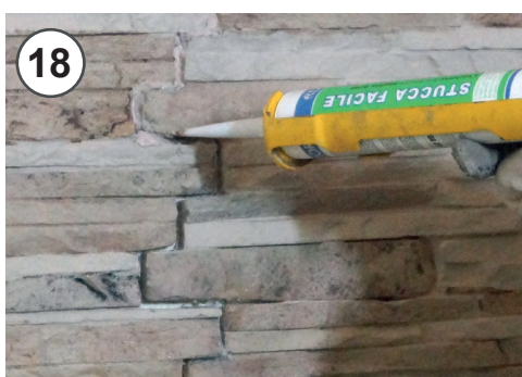
18 - Applicare una quantità minima di stucco in modo da evitare sbordature in caso di necessità è preferibile ritornare a rabboccare il giunto 18 - Apply a minimum quantity of filler in order to avoid overflowing, if necessary is preferable return to top up
